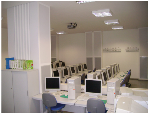
Quelllüftung PC- Raum, HTW Dresden (FH)
