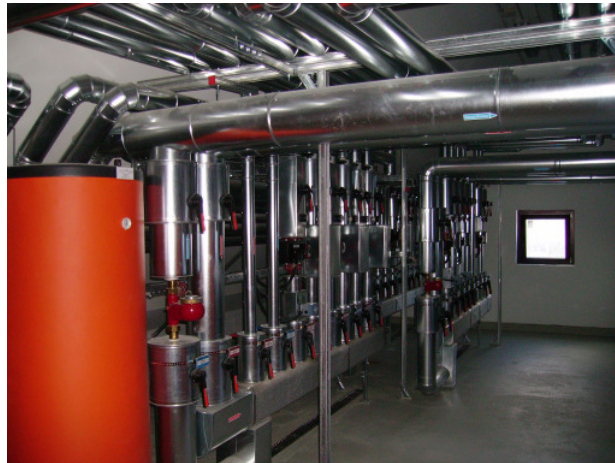
Dachheizzentrale, Krankenhaus Großschweidnitz
